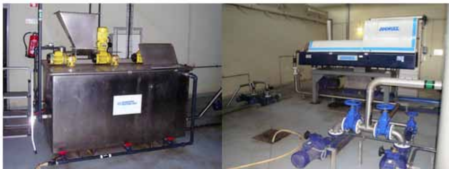
Figura 10 Equipamentos de desidratação de lamas da ETAR da Charneca
